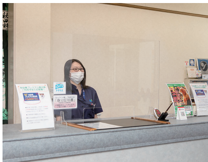
フロントカウンターに飛沫防止透明アクリル板を設置
